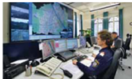
Der Verkehrsrechner Sitraffic Scala in der Wiener Rossauer Kaserne: für fließenden Verkehr und weniger Schadstoffausstoß.
